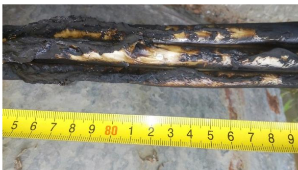
г) Рисунок 1 – Ілюстрація етапів експерименту (а, б, в) та пошкодження кабельного пучка при випробуванні за вогневим впливом (г)
