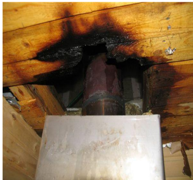
Рисунок 1 – Наслідки порушення правил пожежної безпеки при монтуванні димоходів крізь перекриття з горючих будівельних матеріалів
