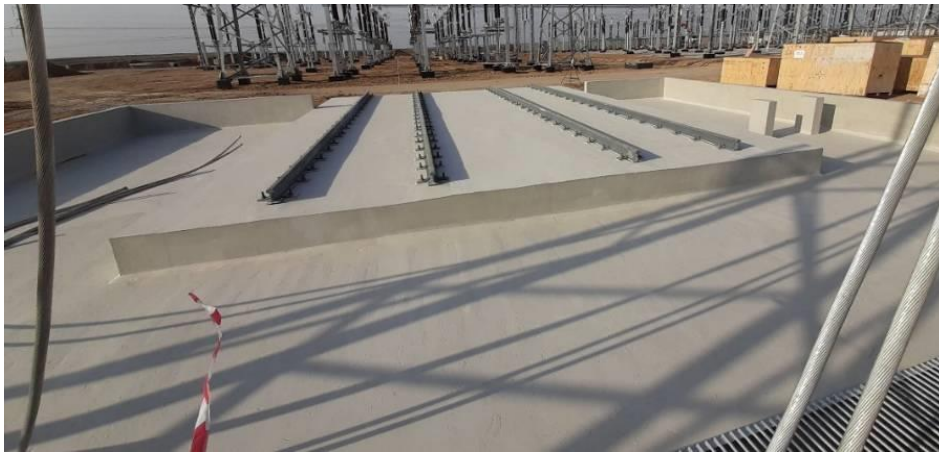
Рисунок 4 – Зовнішній вид площадки маслоприймача трансформаторної підстанції
