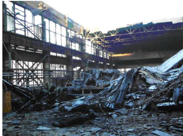
Рис. 2. Характер руйнувань після вибуху воднево-оливної суміші в турбогенераторному залі ТЕС
