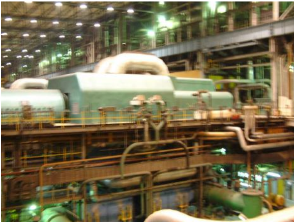
Рис. 1. Турбогенераторний зал ТЕС до вибуху
