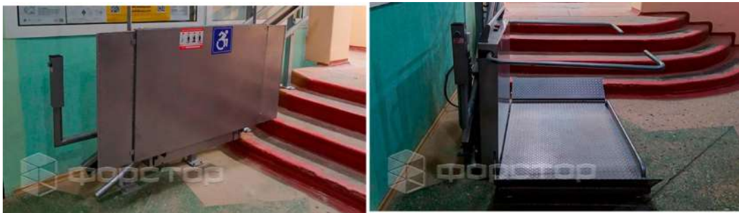
Рис. 1. Встановлення похилого підйомника на шляху евакуації у закладі охорони здоров'я
